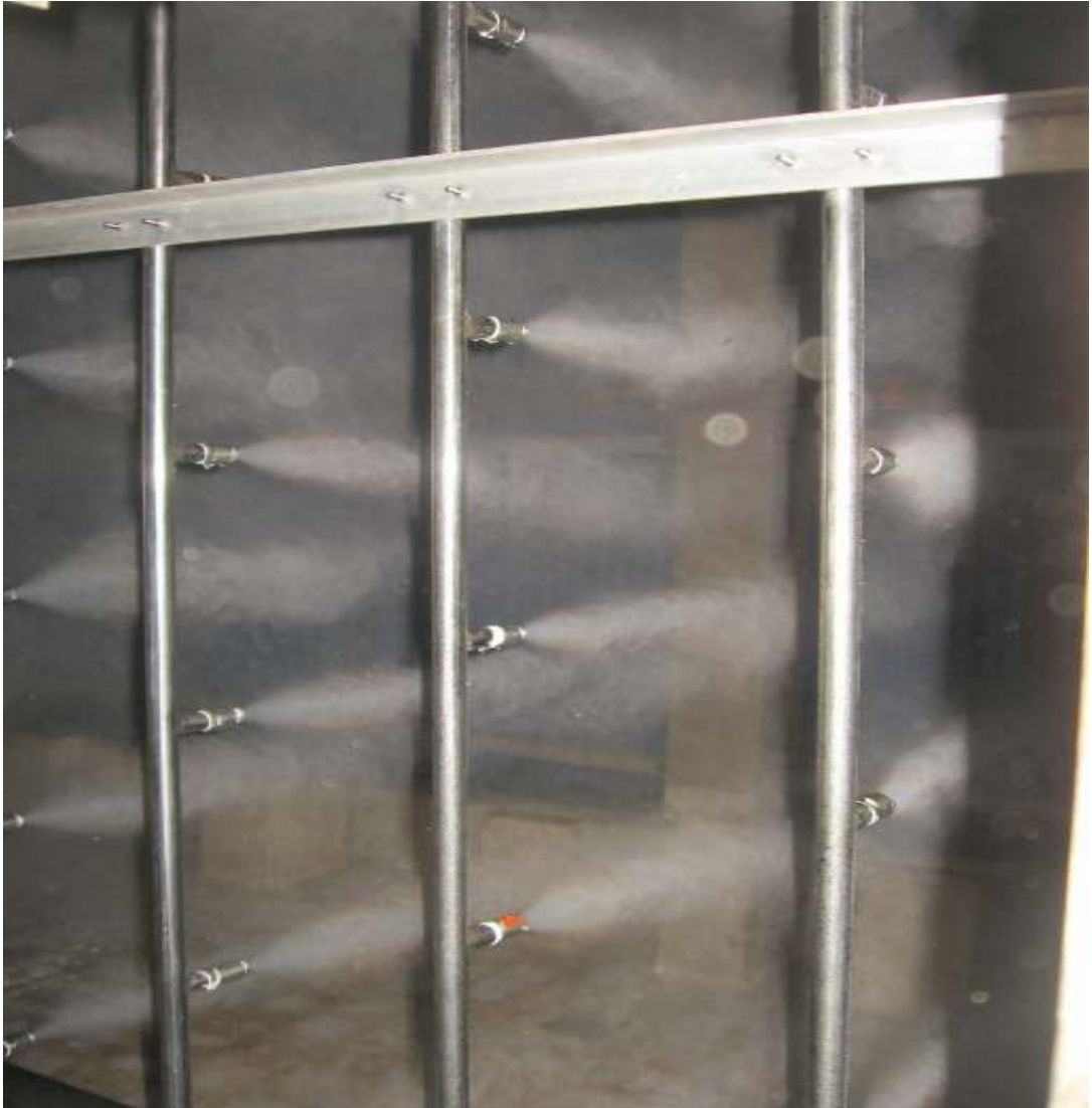
E. HIGH PRESSURE HUMIDIFIER FOG
